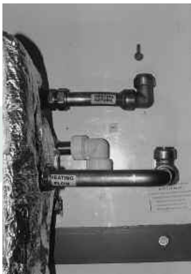
Εικόνα 5-1: Προσαγωγή και επιστροφή λέβητα
