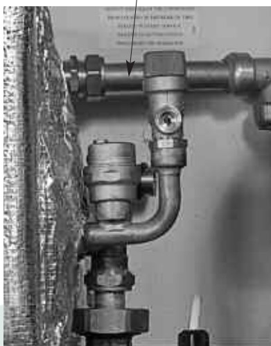
Εικόνα 4-10: Εγκατάσταση Προσαγωγής & Επιστροφής
